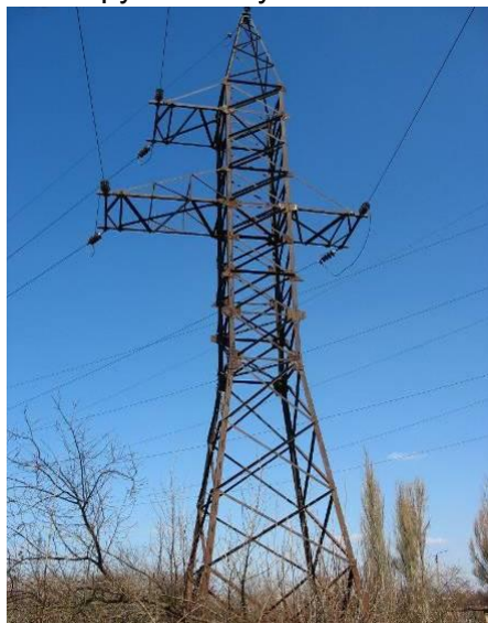
а) опора ВЛ 35 кВ
