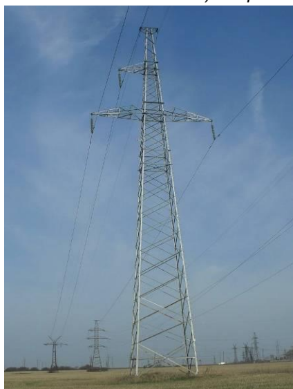
в) опора ВЛ 220 кВ
