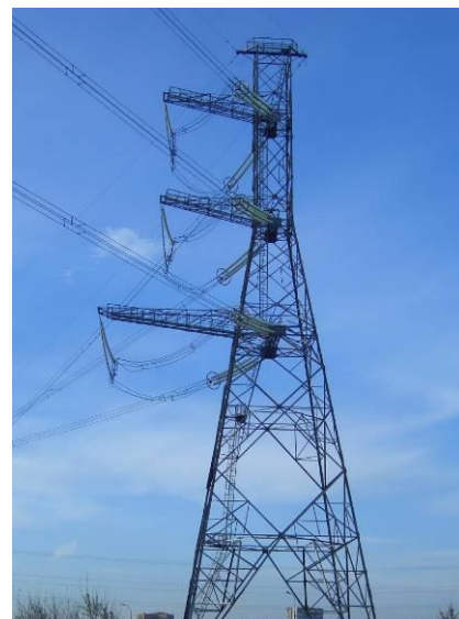
д) опора ВЛ 500 кВ
