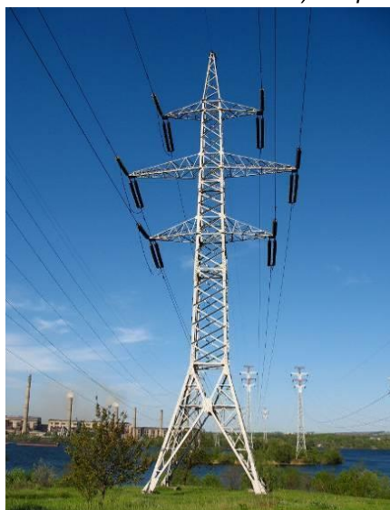
г) опора ВЛ 330 кВ
