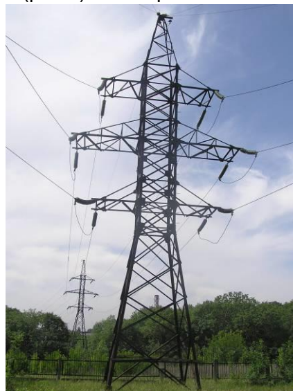
б) опора ВЛ 110 кВ
